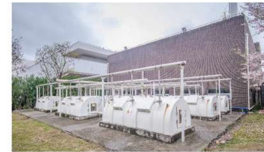
爱茉莉上海美丽妆园废水曝气池
