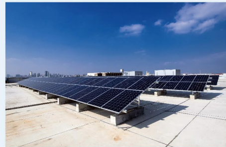
光伏发电系统
